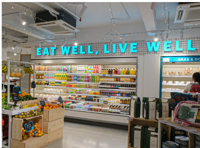
เครื่องปรับอากาศชนิดคาสเซ็ทติดตั้งที่ Qra The Five
