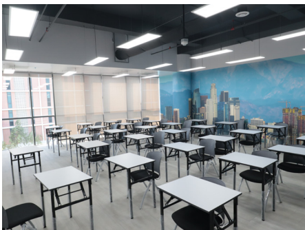
Bộ phát nanoe™ X gắn trần air-e được lắp đặt tại một trong các lớp học.
