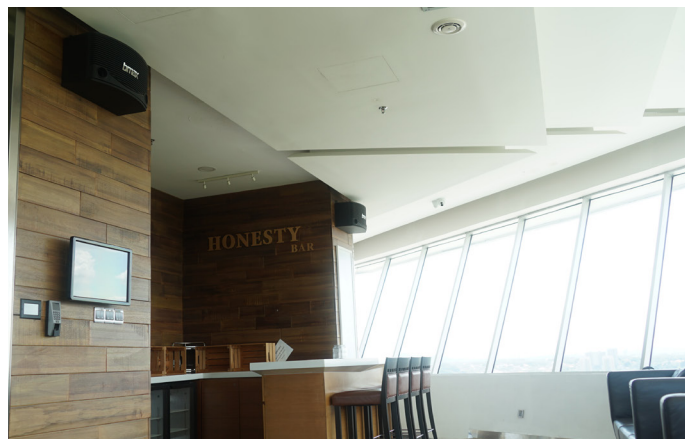
Bộ phát nanoe™ X gắn trần air-e cung cấp không khí sạch trong khu vực nhà ăn.
