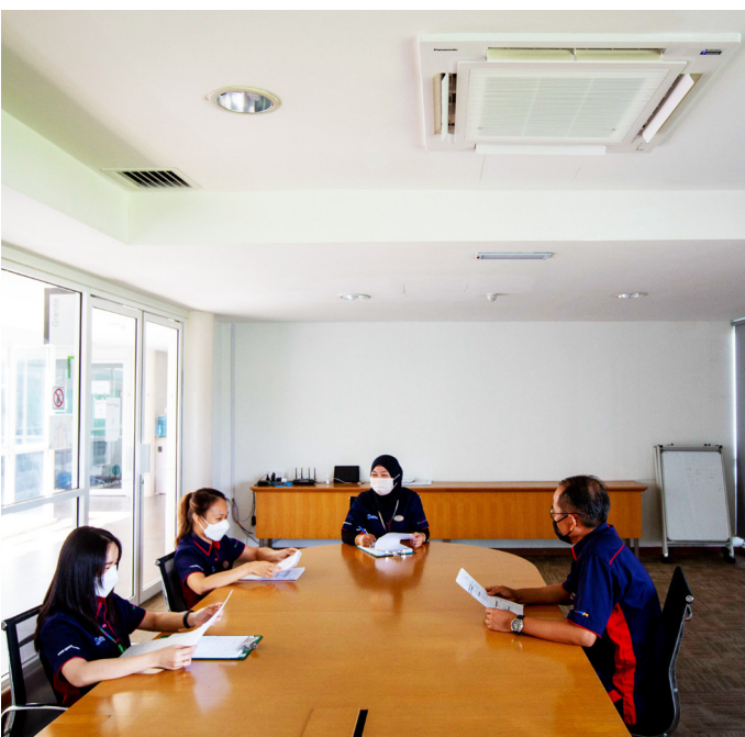
เครื่องปรับอากาศชนิดคาสเซ็ทที่มี nanoe™ X ติดตั้งอยู่ในห้องประชุมของศูนย์ Alam Welcome Centre
