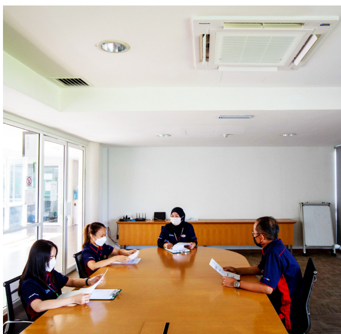
Máy điều hòa không khí âm trần được trang bị công nghệ nanoe™ X được lắp đặt trong phòng họp của Trung tâm chào mừng Setia Alam.
