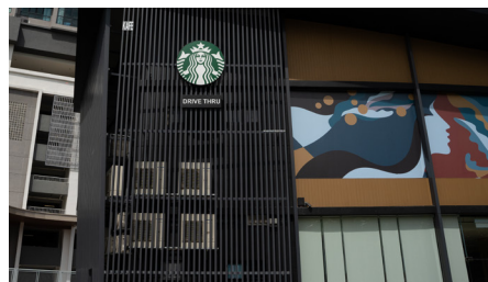
Dàn nóng được lắp đặt tại Starbucks Conezion Putrajaya.
