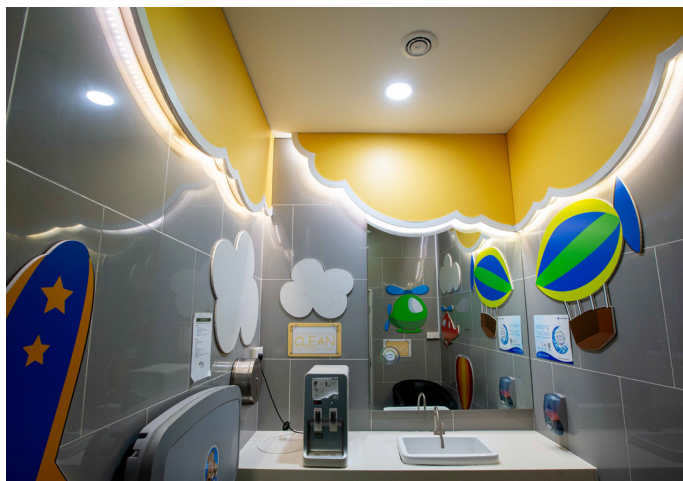
Lắp đặt bộ phát nanoe™ X air-e trong phòng vệ sinh tại gateway@klia2.
