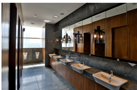
Lắp đặt bộ phát nanoe™ X air-e trong nhà vệ sinh tại Khách sạn New World Petaling Jaya.
