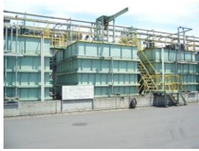
廃液処理施設
