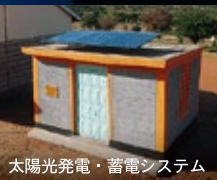
太陽光発電・蓄電システム
