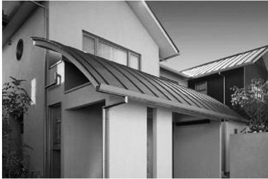
図1 軒先に施工された雨樋
