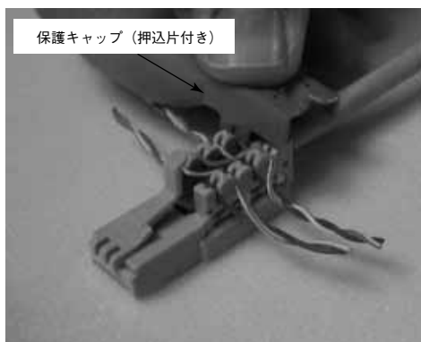
図5 保護キャップを使ったケーブル接続
