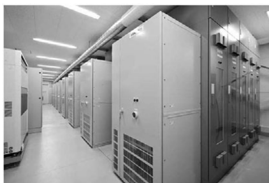
第3図 大規模蓄電システムの全景 Fig. 3 View of mega battery system
