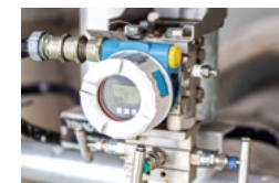
水道・ガスメーター
